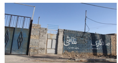
تصویر ۱۸ - وجود مواد زاید ساختمانی و رنگ آمیزی‌های نامناسب و مصالح زیر در نما عکس؛ نگارنده
